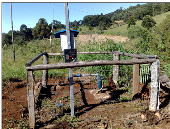
Foto – Poço Linha Planalto
