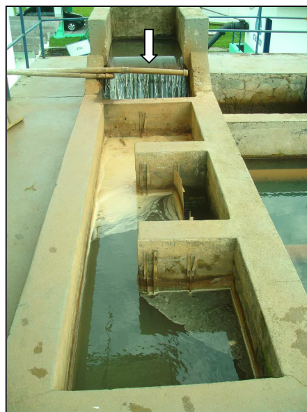
Foto – ETA – Entrada de Água e Mistura Rápida
