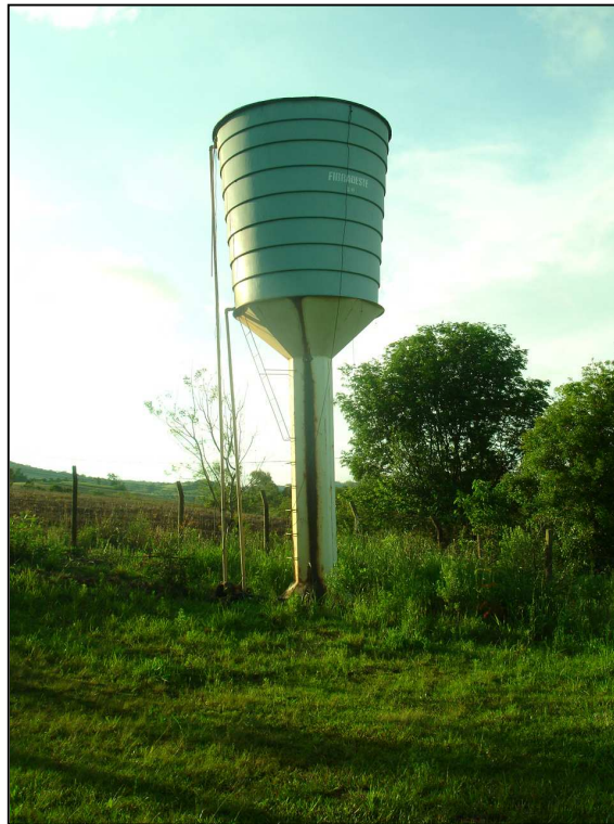
Foto – Reservatório Distrito de Pres. Juscelino
